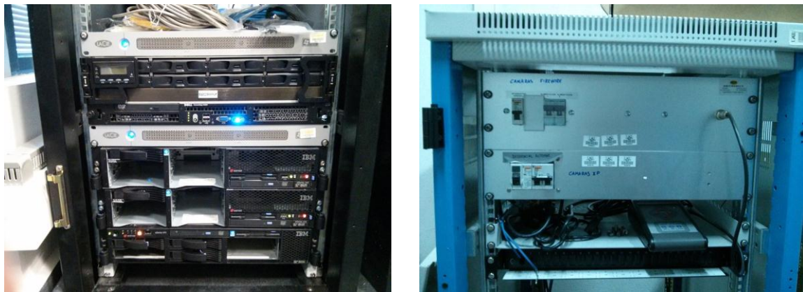
Figura 11. Detalle de equipos de proceso (izda.) y del punto de acceso y control de parte de las cámaras (dcha.).
