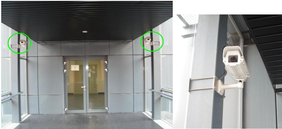
Figura 2. Situación de las cámaras fijas de la planta 3 (izda.) y detalle de una de las cámaras montadas (dcha.)
